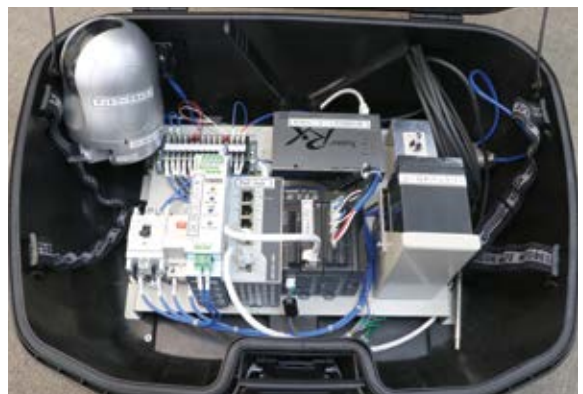
12Vのシールドバッテリー内蔵により、6時間以上のデータ送信を可能としている。
